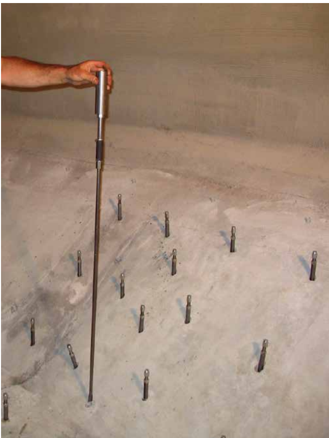
Trinkwasserbehälter „Schwarze Pumpe“
