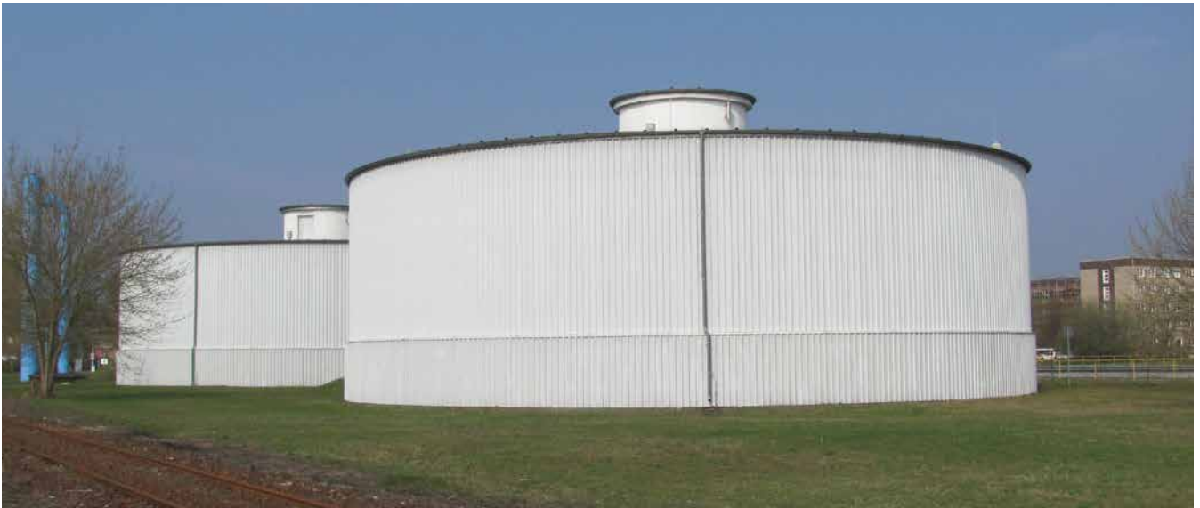
Trinkwasserbehälter „Schwarze Pumpe“
